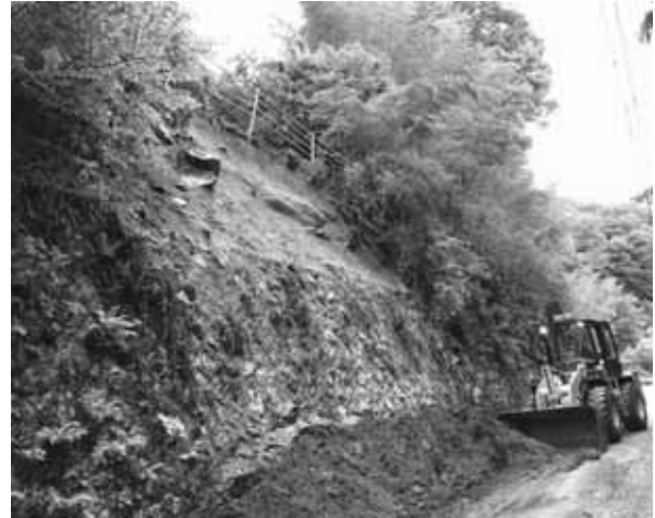
昨年の災害復旧状況
